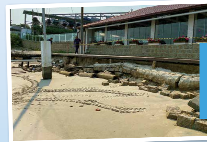
RECONSTRUÇÃO DO DECK E RAMPA DA PRAIA APÓS RESSACA DE SETEMBRO DE 2022.
